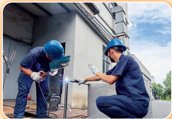
7月20日,37℃气温下,明日软包装公司员工叶国鑫、曹永洪在工厂外维修焊接用于车间使用的小推车。 摄影:明日控股 周佳钰
